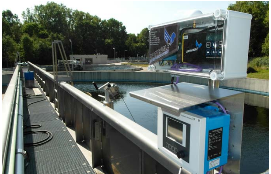
Messwerte werden drahtlos vom DATAEAGLE zur PLC übertragen
