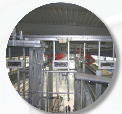
2. Der DATAEAGLE sitzt direkt in der Deckenkonstruktion und ist die Basisstation (Master).
